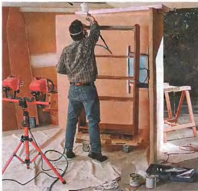
Кабина для покраски установлена в проеме ворот гаража. Вентилятор вытягивает вредные взвеси краски и растворителя через фильтр и выбрасывает их наружу.
